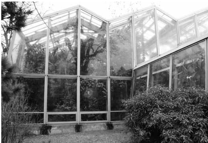
Erneuerungsbedürftig: Tropenhaus im Botanischen Garten Foto rm
